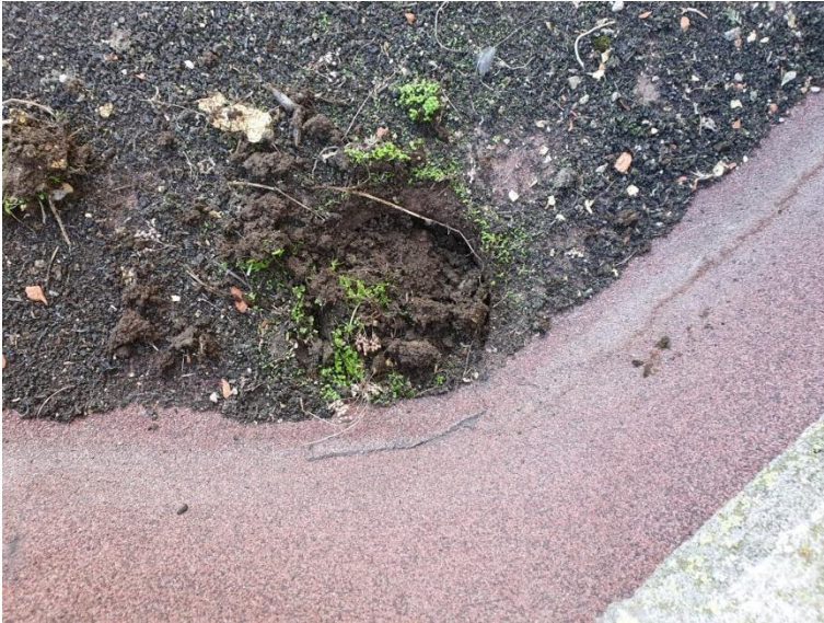
Foto 7 – Sumidero en cubierta
