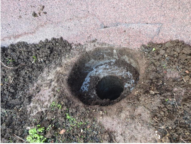
Foto 8– Detalle sumidero una vez retirada la suciedad.
