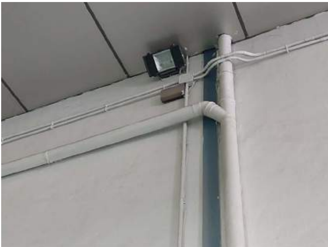
PARCELA A-4, AVENIDA DE LOBETE Nº 44 DE LOGROÑO (LA RIOJA) DETALLE DE LAS INSTALACIONES DE PROTECCIÓN CONTRA INCENDIOS
