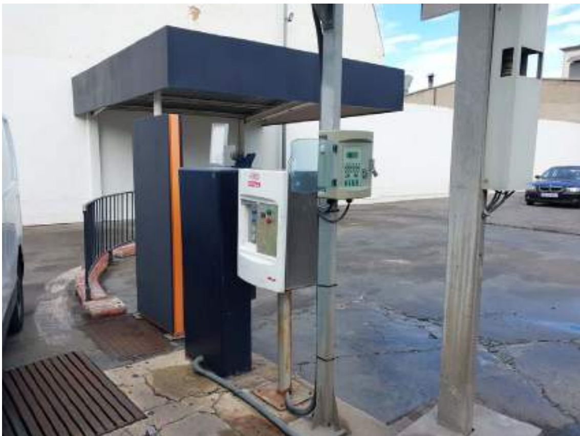
PARCELA A-5 AVENIDA DE LOBETE Nº 46 DE LOGROÑO (LA RIOJA) VISTA DEL SEGUNDO TREN DE LAVADO Y DE LAS INSTALACIONES DE MANIOBRA
