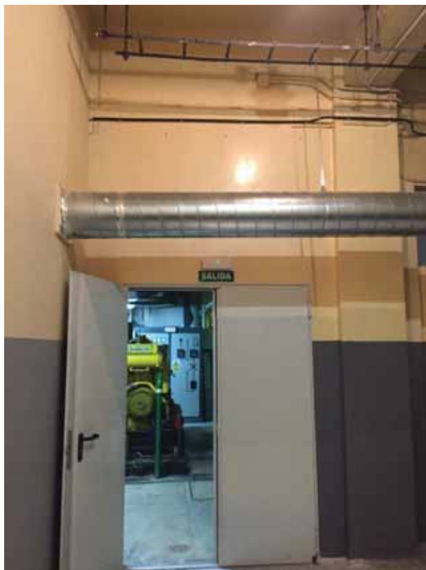
SALA ENTRADA MATERIALES
