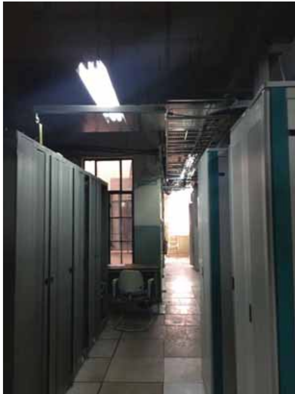
SALA DE TRANSMISION
