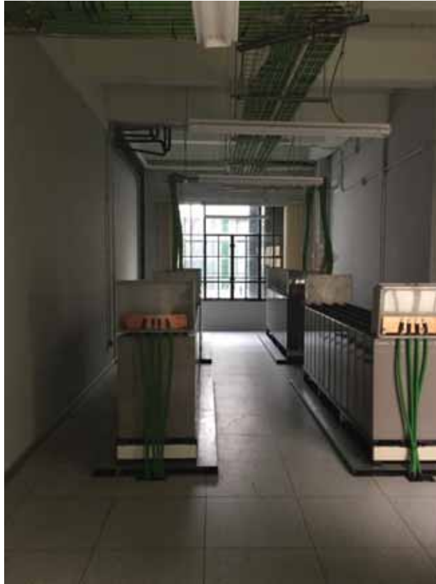
SALA CUADROS FUERZA Y BATERIAS
